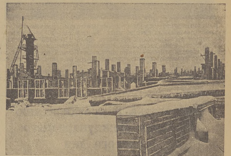
Так выглядит стройка цеха ячеистых бетонов на заводе № 3 треста «Стройдеталь». Этот цех работники УНР-290 должны были сдать в эксплуатацию в текущем году. Как видно на снимке, строители УНР-290 не торопятся, а руководители треста № 97 не спрашивают с них ответственности за такое отношение к одной из первоочередных строек семилетки.
