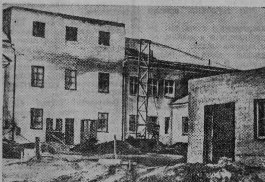
Основательно запарились с баней строители, забыв при этом о своих обещаниях и долге. Чтобы вернуть их в чувство, нужна хитрая хитрость. Иначе сей объект (смотри фото) простоят в таком неприглядном виде до...
