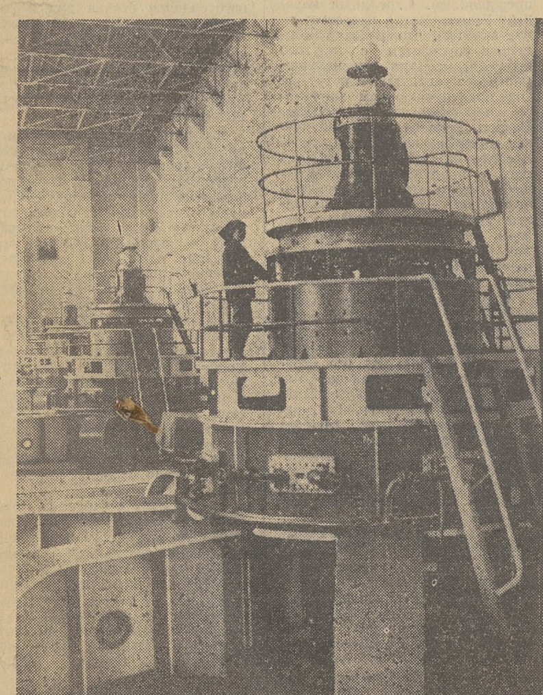
КИРГИЗСКАЯ ССР. Уч-Курганская ГЭС — первенец каскада электростанций на горной реке Нарын. Мощность ее — 180 тысяч киловатт! Гидроузел имеет и большое водохранилище. Братские республики Средней Азии получают не только дешевую электроэнергию этой станции, но и воду для орошения плодородных земель. Энергия Уч-Курганской ГЭС идет и на строительную площадку Токтогульской станции, которая будет второй на Нарыне. НА СНИМКЕ: машинный зал гидроэлектростанции. Фото А. Кадыркулова. (Фотохроника ТАСС).
