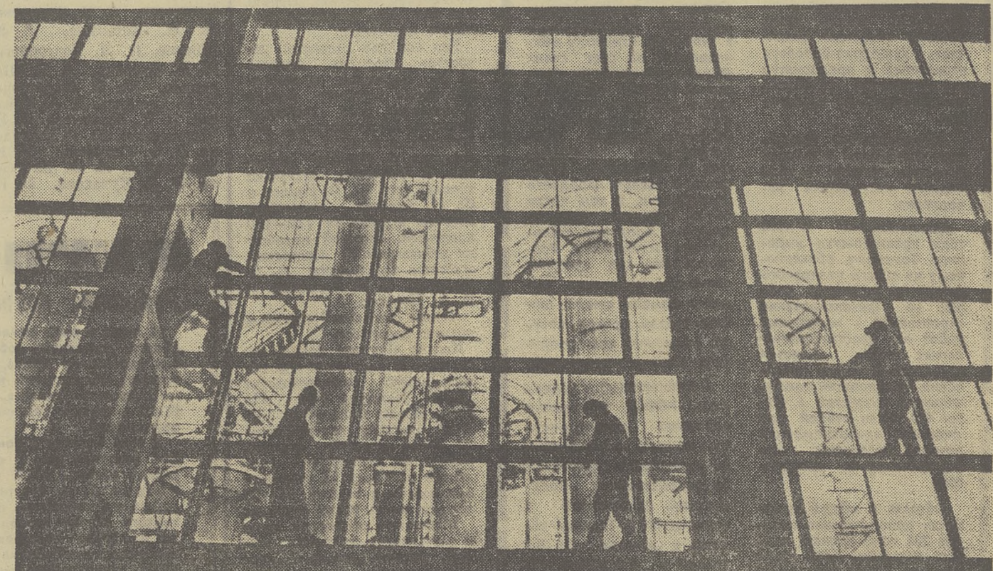
ВОЛОГДСКАЯ ОБЛАСТЬ. Полным ходом идет монтаж технологического оборудования на строительстве Череповецкого азотно-тукового завода. Он будет производить сотни тысяч тонн аммиака в год. НА СНИМКЕ: на строительстве главного корпуса Череповецкого азотно-тукового завода. Фото Ю. Беллинского, Фотокхроника ТАСС.
