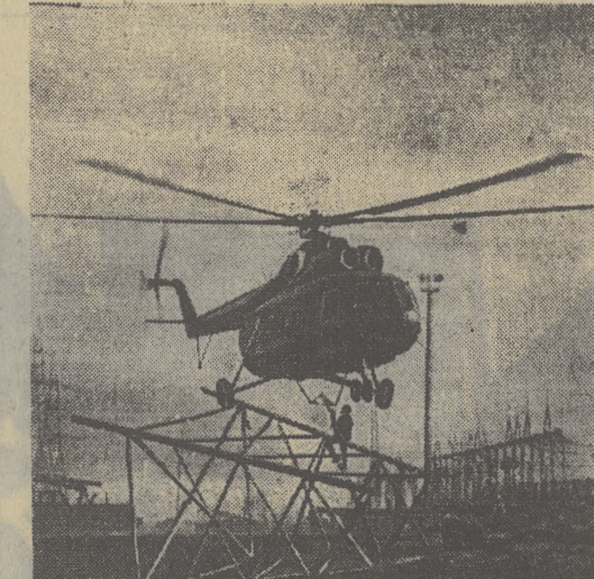
Тюменская область. Ускоренными темпами электрифицируется крупнейшее на востоке страны Самоярское месторождение нефти. За последние время к нему подведены мощные ЛЭП, передающие энергию электростанций Сибири и Урала промышленным, буровым, строительным и другим объектам. На непроходимых топях, в таежной глухомани прокладываются новые высоковольтные линии, сооружаются подстанции.
