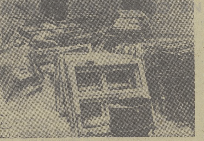
В таком виде хранятся строительные материалы возле одного из строящихся домов.
