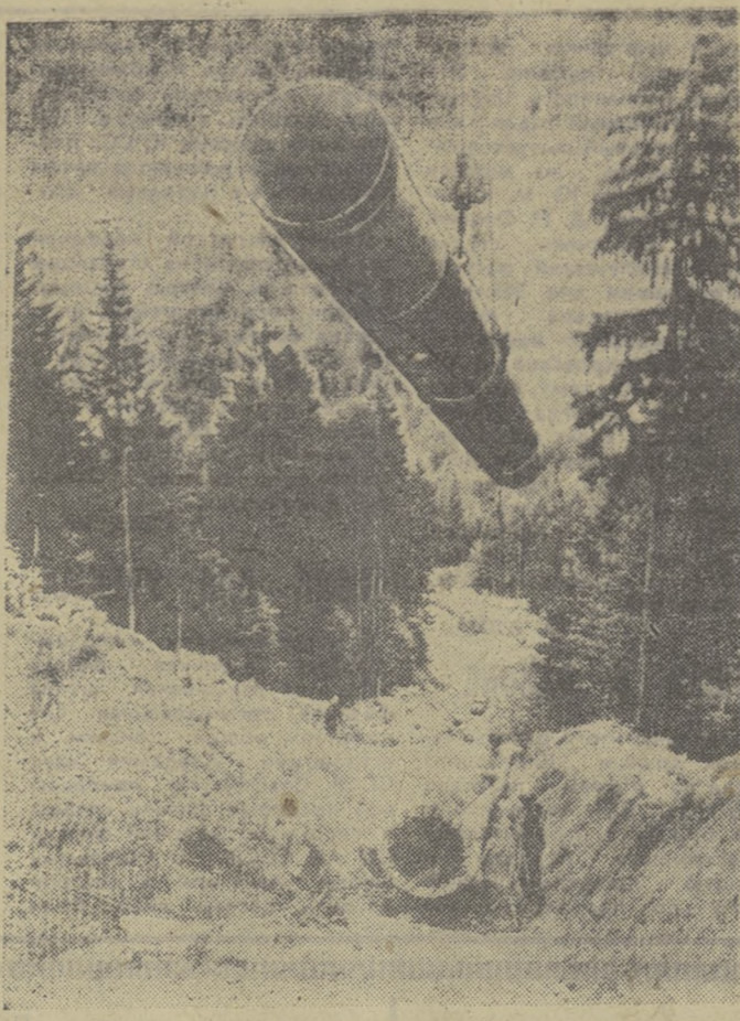
В Италии по газопроводу поступает советский природный газ. В страну уже поставлены сотни миллионов кубометров ценного энергетического сырья, а с 1977 года будет поступать по 6 миллиардов кубометров газа в год. Работы в Италии еще идут. До плановой конечной станции газопровода Серьяно в Ломбардии нужно проложить около 170 километров.
