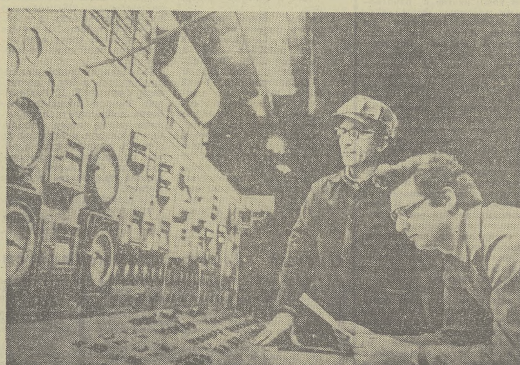
Сердцем ГРЭС-II называют котельный цех станции.
