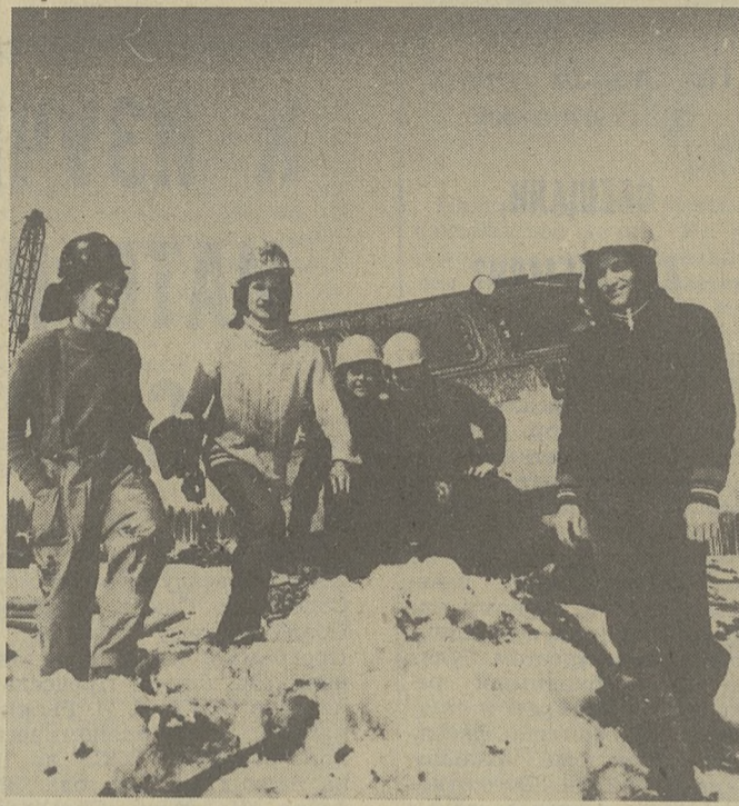
Вот бригада капитального ремонта скважин: помбур Юрий Семенов и Халим Насруллин, бурильщик Виктор Станев, машинист Сергей Кабаненко и их бригадир Владимир Тоноян.
