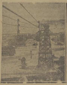
На снимке: Кемеровская подстанция дороги.
